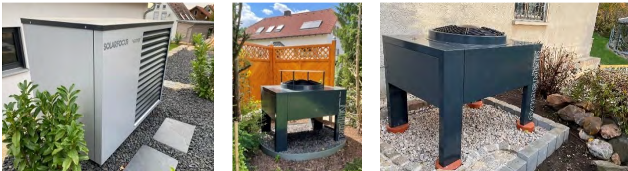
Abbildung 62: Luft-Wasser-Wärmepumpe als Monoblock(l.) 42 , oder als Splitgerät (Luftkühler m. und r.) 43
